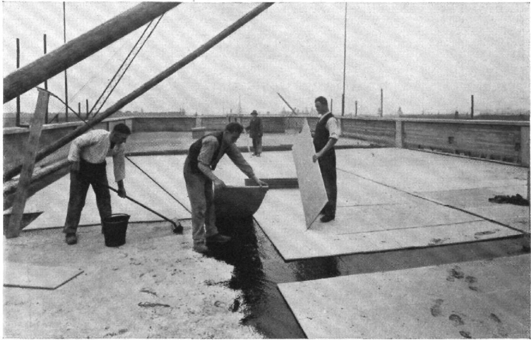
ABB. 22 / DAS GEWERKSCHAFTSHAUS IN FRANKFURT AM MAIN / BEI DER EINDECKUNG DES DACHES Das Bild zeigt das Verlegen der Korkplatten in Asphalt unmittelbar auf den Ausgleichbeton über der Züblin-Decke. Die Korkplatten wurden in 2 Lagen mit Pappe abgedeckt, hierauf kam, wie man im Hintergrund sieht, der Bimsbeton mit Gefälle und auf diesen 4 cm starke Platten in Zementbeton, die Fugen mit Asphalt vergossen.
