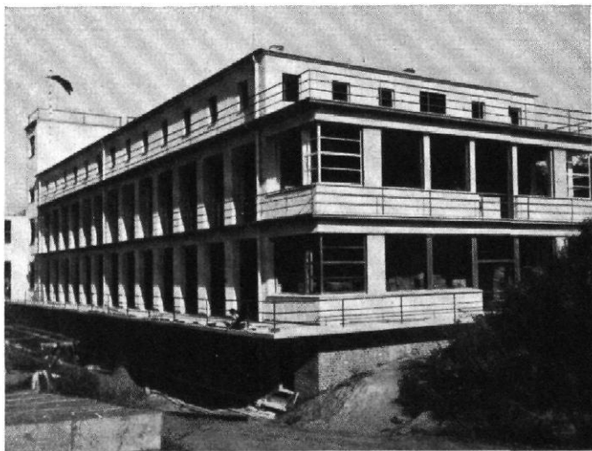
Abb. 12 / Krankenhaus in Freiberg i. Sa. / Architekt: Georg Salzmann, Freiberg Die chirurgische Abteilung im Bau
