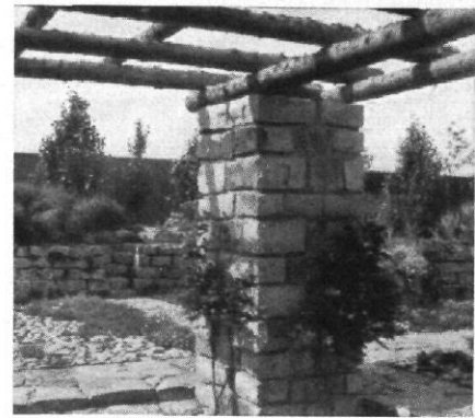
Bild 12 / Zu starker, unsachlicher Pergolapfeiler
