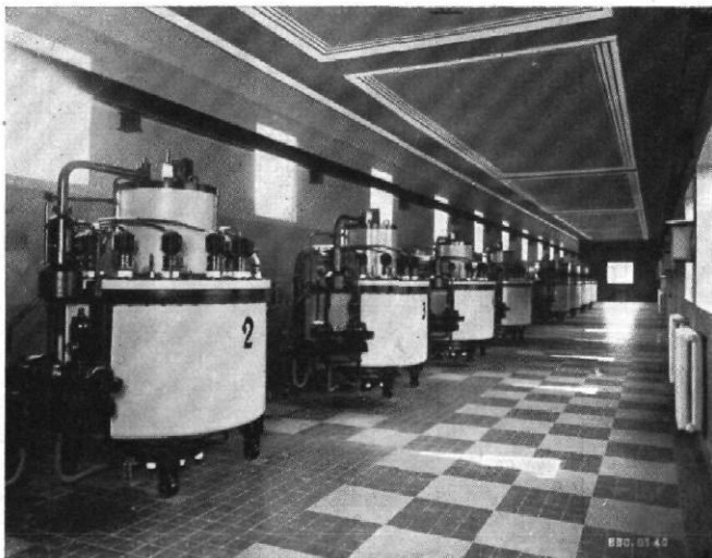
Abb. 12 / Schaltwerk Halensee / Gleichrichterraum
