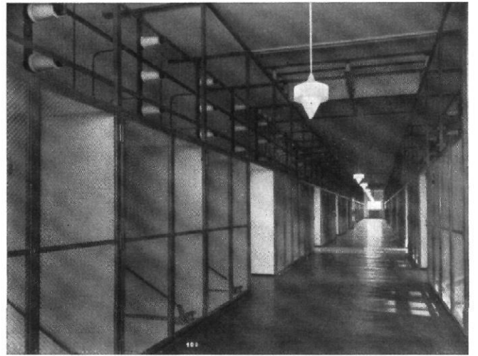
Abb. 9 / Schaltwerk Halensee / Hochspannungshaus, drittes Obergeschoß
