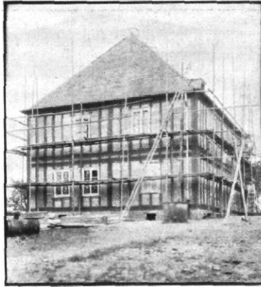
Abb. 44 | Die Rahmen sind mit Bimsbetonplatten ausgesetzt, die Hölzer sind mit Ziegeldraht überspannt
